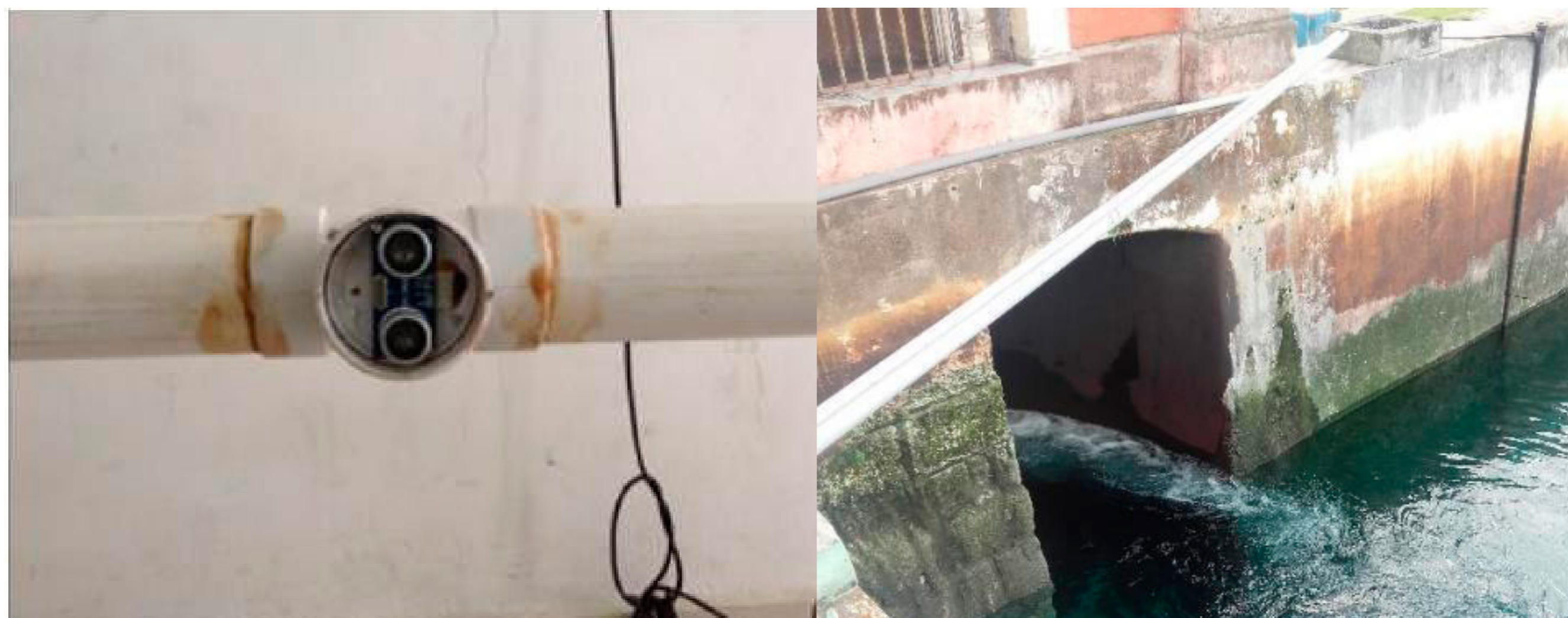
Figura 9. Sistema en funcionamiento.
